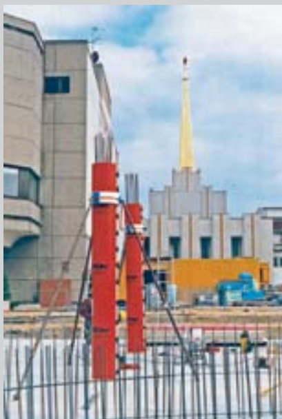
Svislé vyrovnání bednění Tubbox Multi pomocí vzpěr připevněných napínacím popruhem na vyrovnávací prsteneček.
